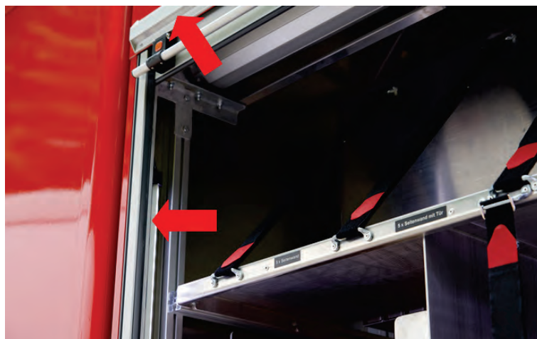
Abbildung 51: Geräte-raumbeleuchtung, LED-Langfeldleuchten innen und außen (Fabr. LDR).
